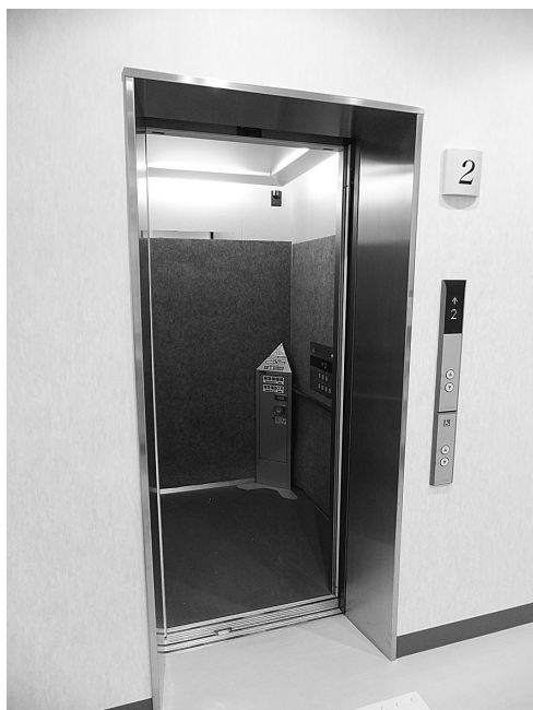
エレベーター
