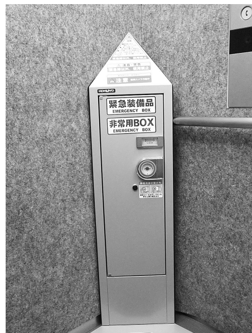
エレベーター内のレスキューキャビネット
