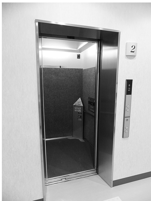
エレベーター
