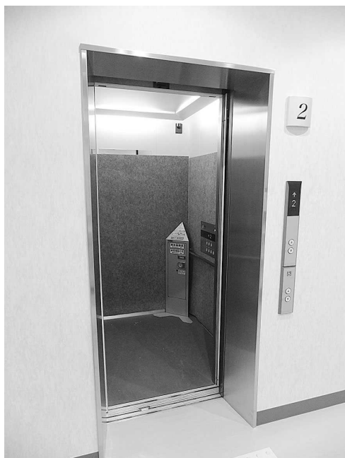
エレベーター
